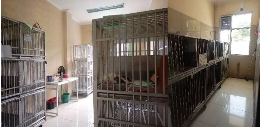
Gambar 5. Kondisi dinding yang kurang terawat dan posisi kandang hewan di ruang rawat inap non infeksius kucing (kiri) dan anjing (kanan) (Sumber: Penulis, 2024)
